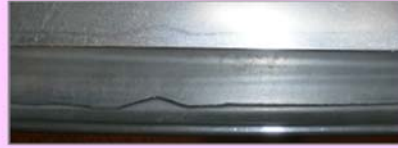
破損している下皿の写真
